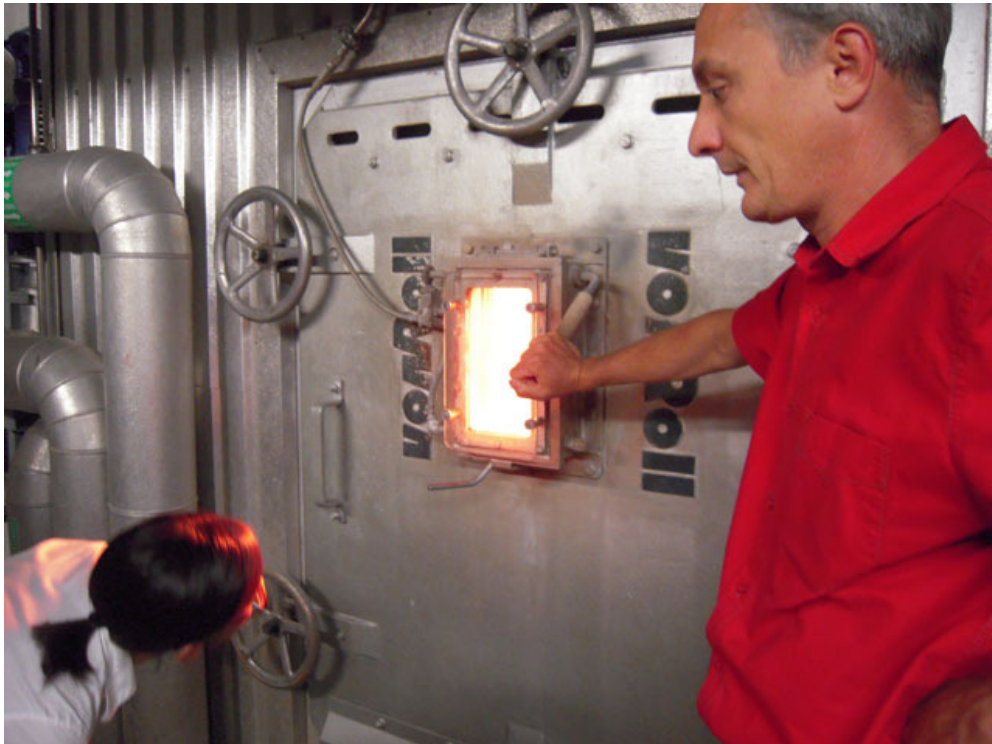
Verbrennungssofen mit Rostfeuerung
